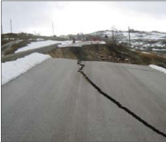
La frana che ha colpito la strada provinciale
